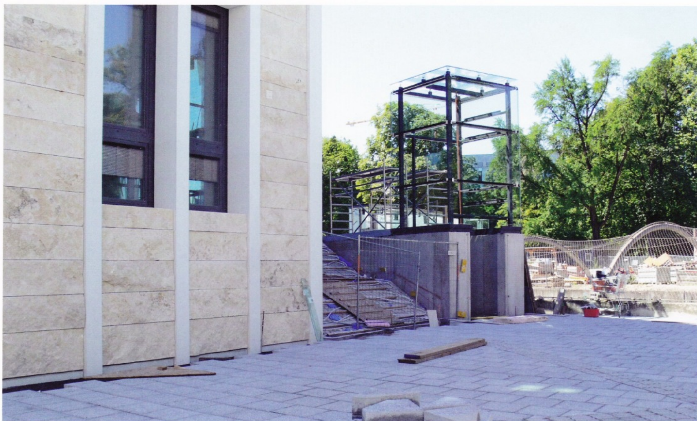
Ecke Blumauerstraße/Volksgarten. Zur Überwindung der Höhenunterschiede zum Theatereingang ist ein behindertengerechter Aufzug errichtet. Das neue Straßen- und Gehsteigpflaster ist fast fertig gestellt.
