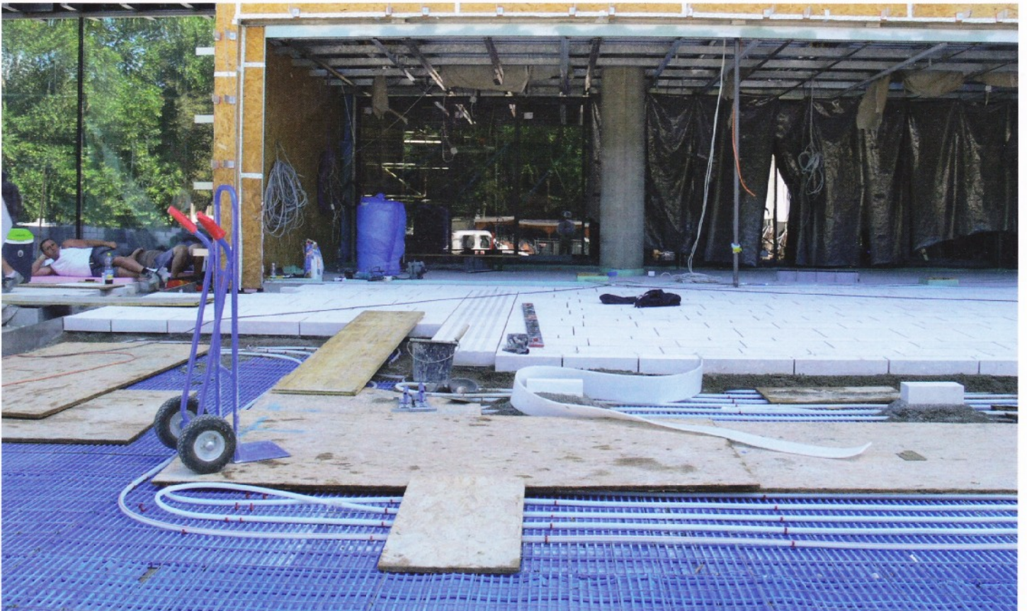
Haupteingang ins Musiktheater mit der Verlegung von Rohren für die Bodenheizung aus Abwärme des Hauses zur Schnee- und Eisfreihaltung.
