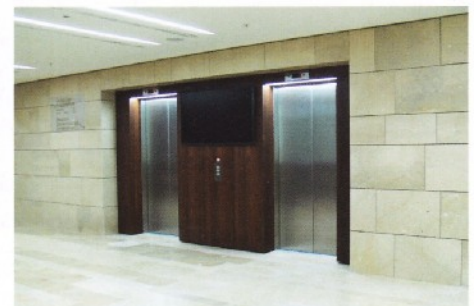
Lifttüren im Garderobenraum (Lifte zum 2. UG, Garage, und zu BlackBox, Orchesterprobesaal, sowie nach oben)
