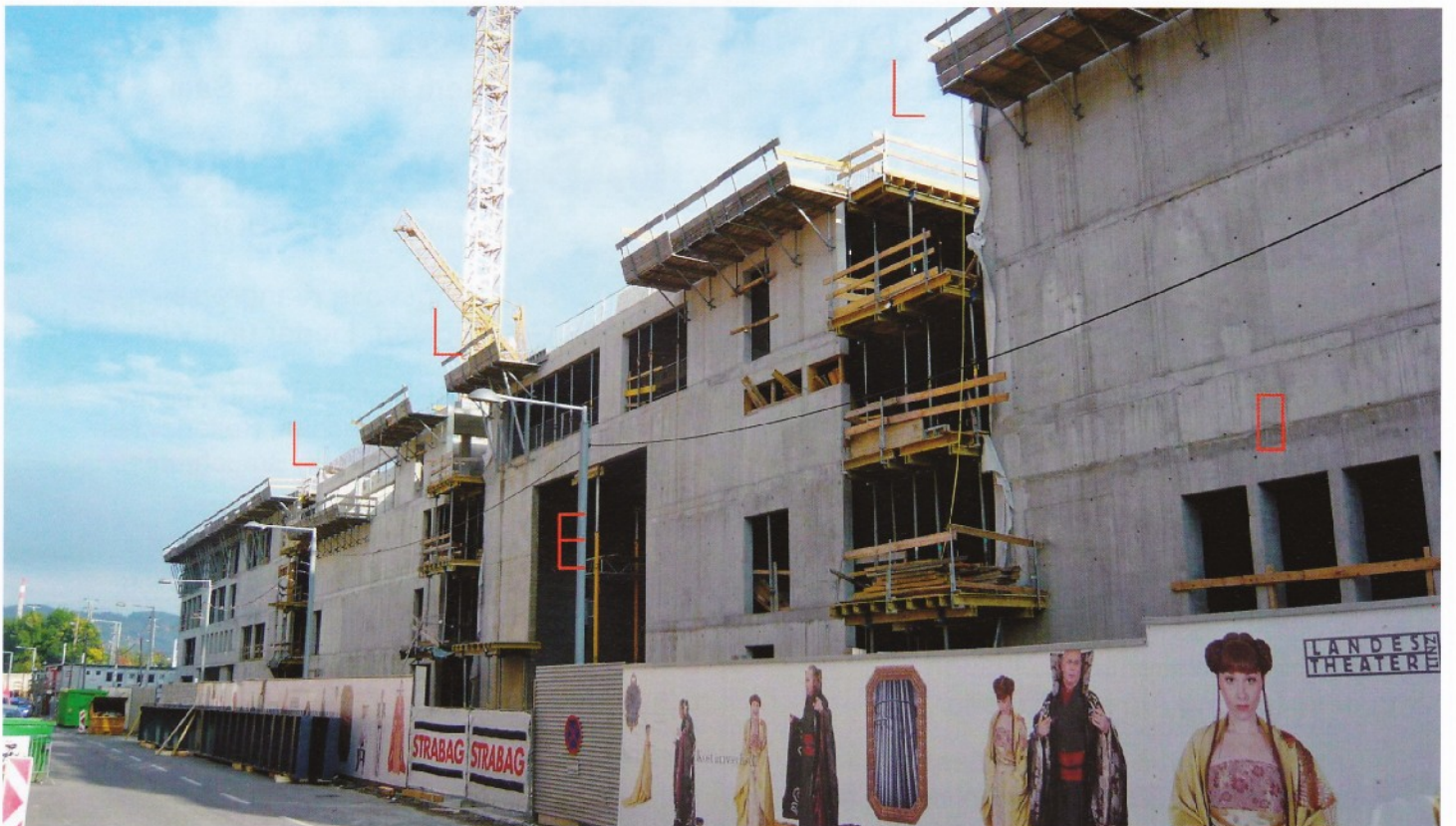
Blumauerstraße: Der Rohbau entlang der Blumauerstraße ist nahezu fertig gestellt. Die Buchstaben „L“ im Bild zeigen die 3 Lichthöfe, die als Pausenräume für die Künstler errichtet werden. „E“ ist eine provisorische Einbringöffnung für die Bühnentechnik und „O“ zeigt die Lage des Orchesterproberaumes. FOTOS UND TEXT: DI HILDEBRAND HARAND
