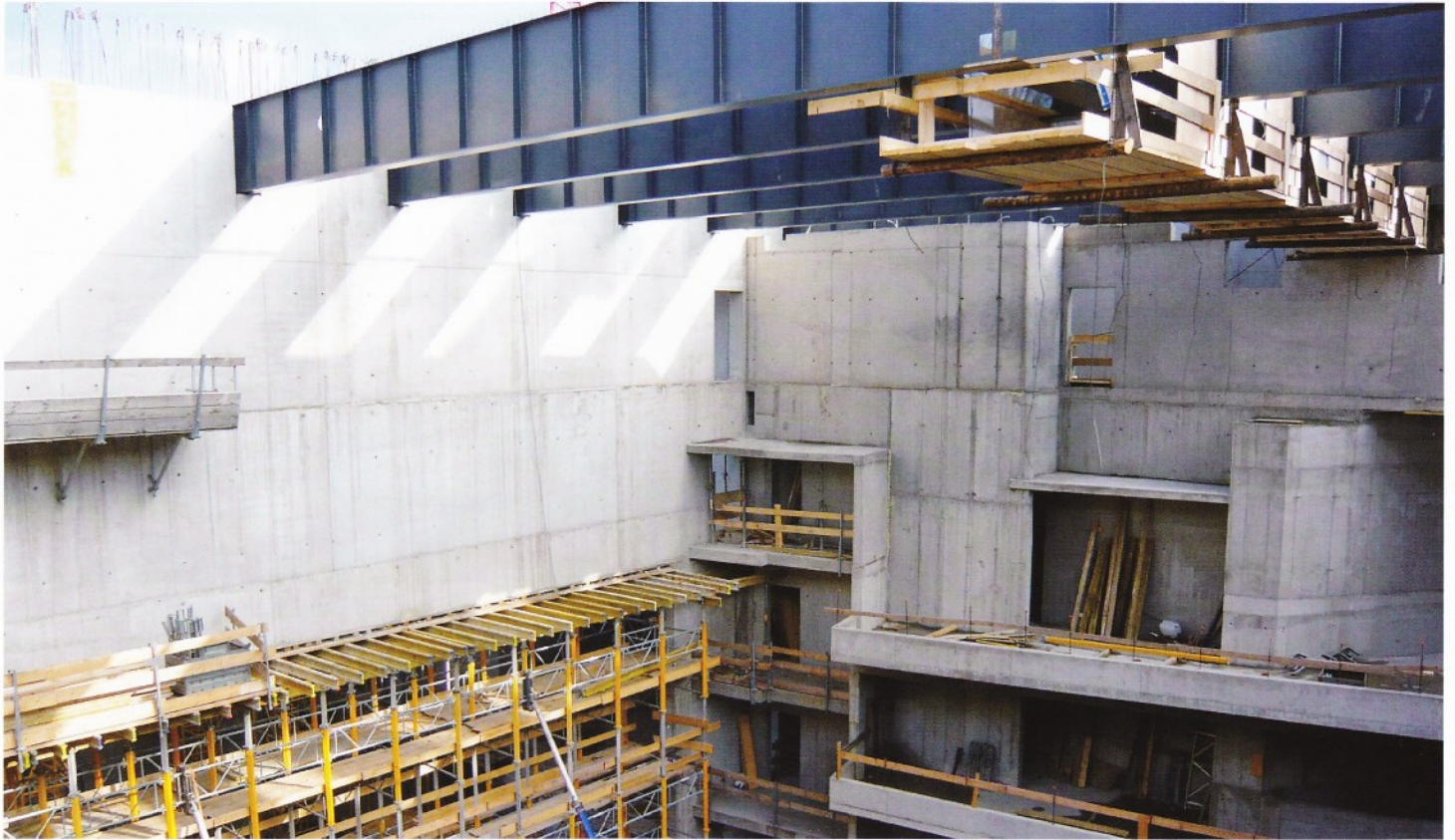
Saalbereich: Über dem Auditorium spannen sich bereits einige stählerne Dachträger. Sie liegen links im Bild auf dem hohen Träger über dem Bühnenportal auf, das noch eingerüstet ist. Auf diesem Träger wird auch der Bühnenturm aufsitzen. Rechts unten die Seitenränge der beiden Galerien.
