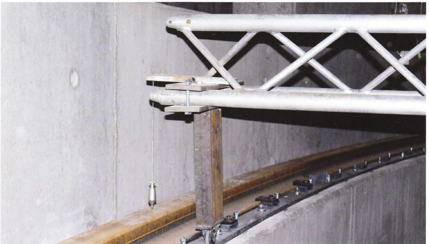
Mit einem etwa 16m langen „Zirkel“ wird die kreisrunde Außenschiene für die Umfangslagerung der Transportdrehzscheibe eingerichtet.
