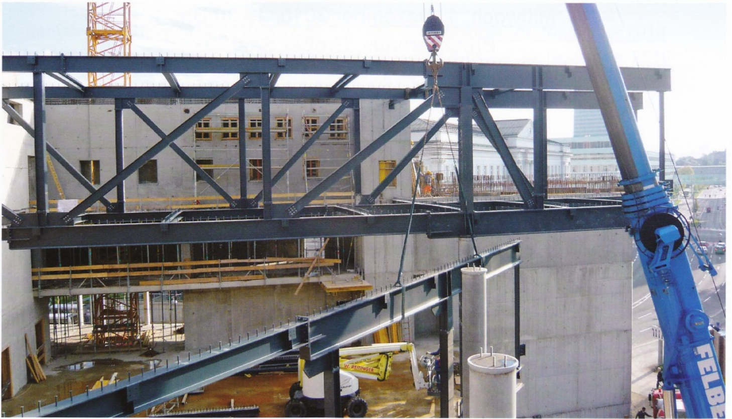
Das Foyer: Die Fassade des großen Foyers zum Volksgarten hat runde Stahlbetonstützen, die das Dach tragen. Auf sie werden gegenwärtig die geschosshohen Stahlfachwerkträger aufgelegt. Rechts von den Stützen kragen sie ins Freie und bilden das Vordach. Einer der Träger liegt noch auf dem Foyerboden (vorne) und wird gerade zusammgebaut.
