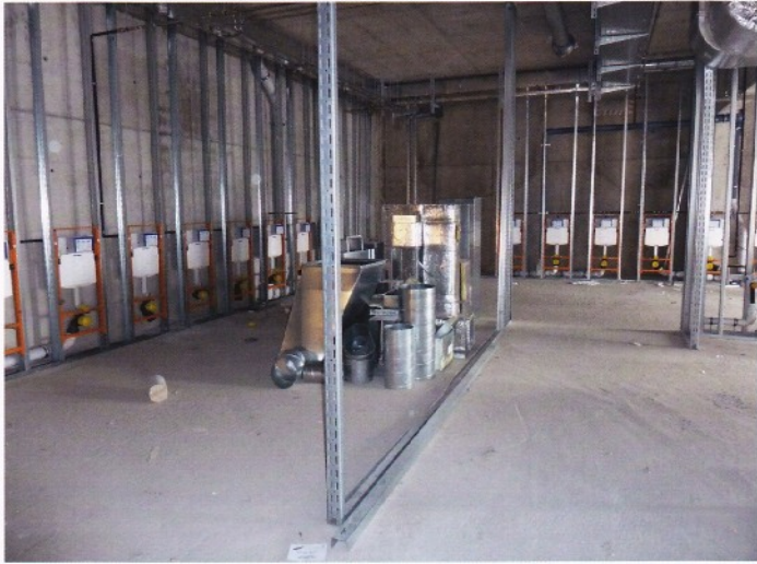
Installation der Rohre und Zwischenwände in den Toilettenanlagen. Weitere zahlreiche Baustellenbilder auf www.musiktheater.at - Foto: Harand
