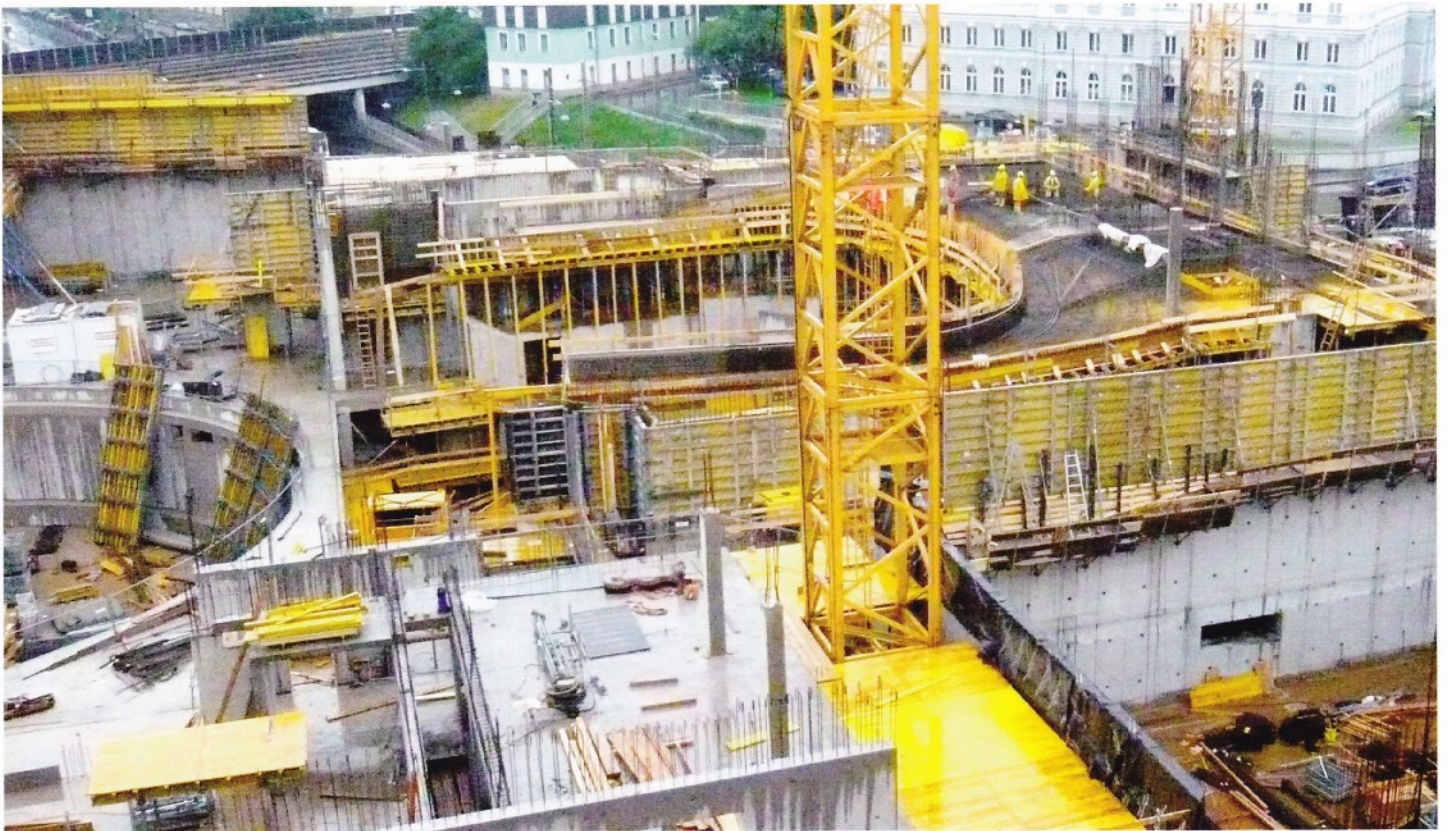
Blick auf das Auditorium (hinter dem Kranturm des Vordergrund). Soeben wird die freitragende Platte des 1. Ranges betoniert. Rechts vorne eine Ecke des Orchesterprobenssaals.
