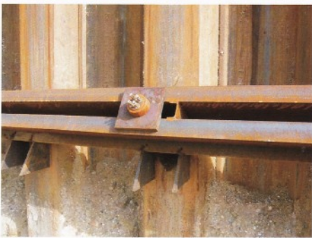
Gezeigt werden die lotrechten Bohlen, die waagrechten Gurten und der Anker samt Platte. Die Gurte müssen durch Dreieckselemente mit den Bohlen verschweißt sein. Sie zeigen die Neigung der Anker im Erdreich.
