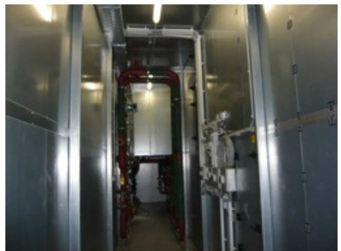
Das Innere der Lüftungsanlage L1.
